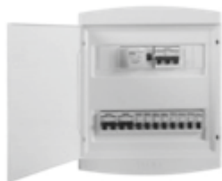
Quadro de Distribuição
